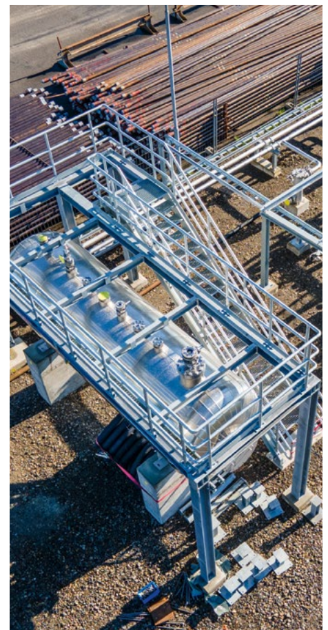
Seit Q2/21 ist die Anlage in Betrieb.
